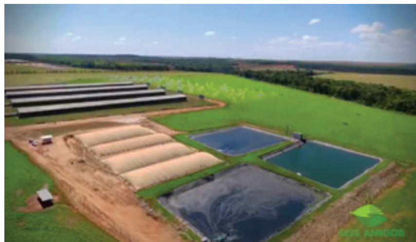
Os dejetos dos suínos são totalmente aproveitados, seja para produzir energia elétrica para a fazenda ou para fertirrigação
